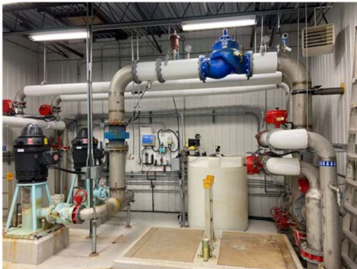
Station de pompage/traitement et réservoir de transit
